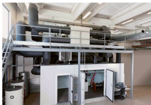
Klimatická komora pro testování rekuperačních jednotek
